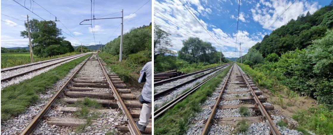
Slika 5: km 531+850, v smeri stacionaže, desni tir, leseni pragi, poškodovani pragi, poškodovan nasip
