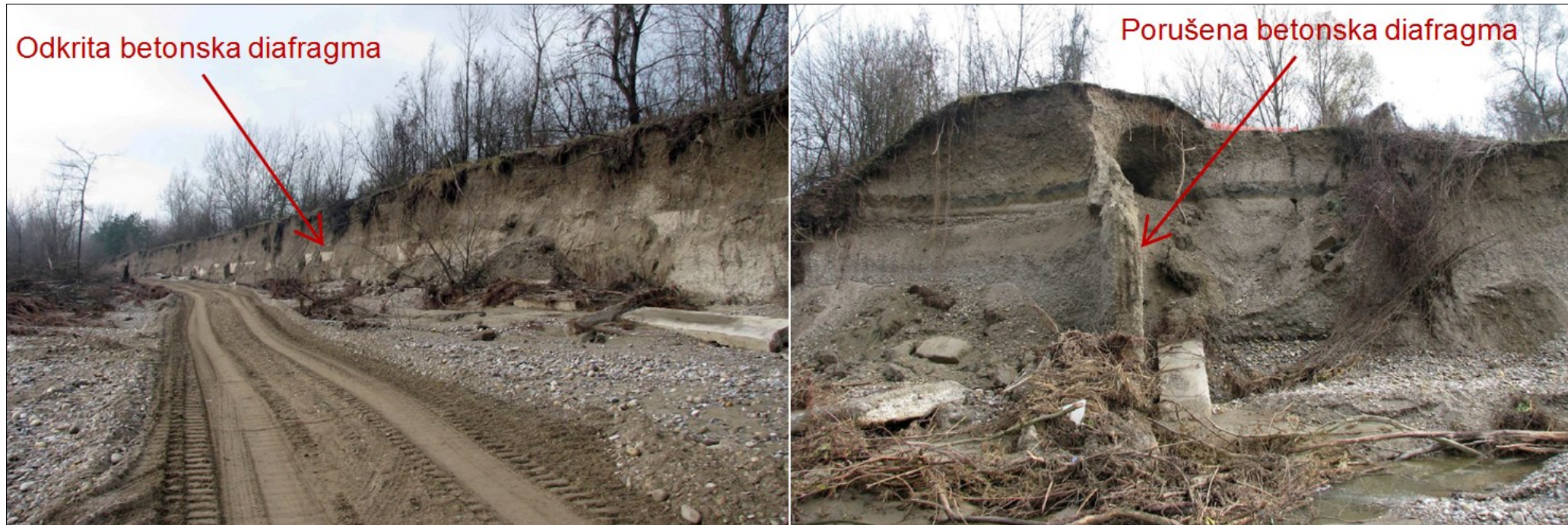
Odkrita in porušena betonska diafragma (Foto: arhiv ZAG)
